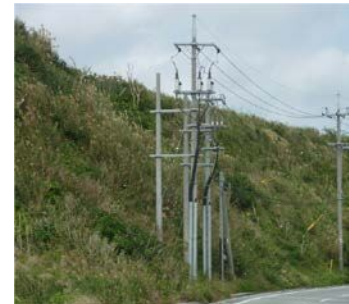
台風に備える多くの電柱
