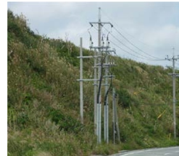
台風に備える多くの電柱
