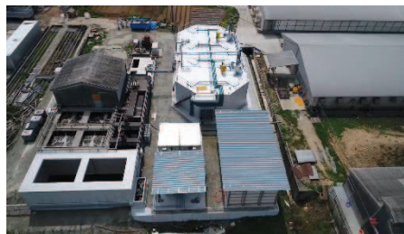
愛知県田原市養豚農家のバイオマス発電施設：50kW
