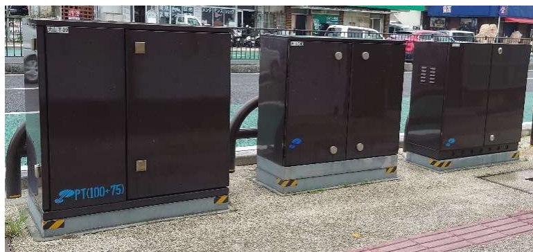
地上機器設置例（宜野湾市内）
