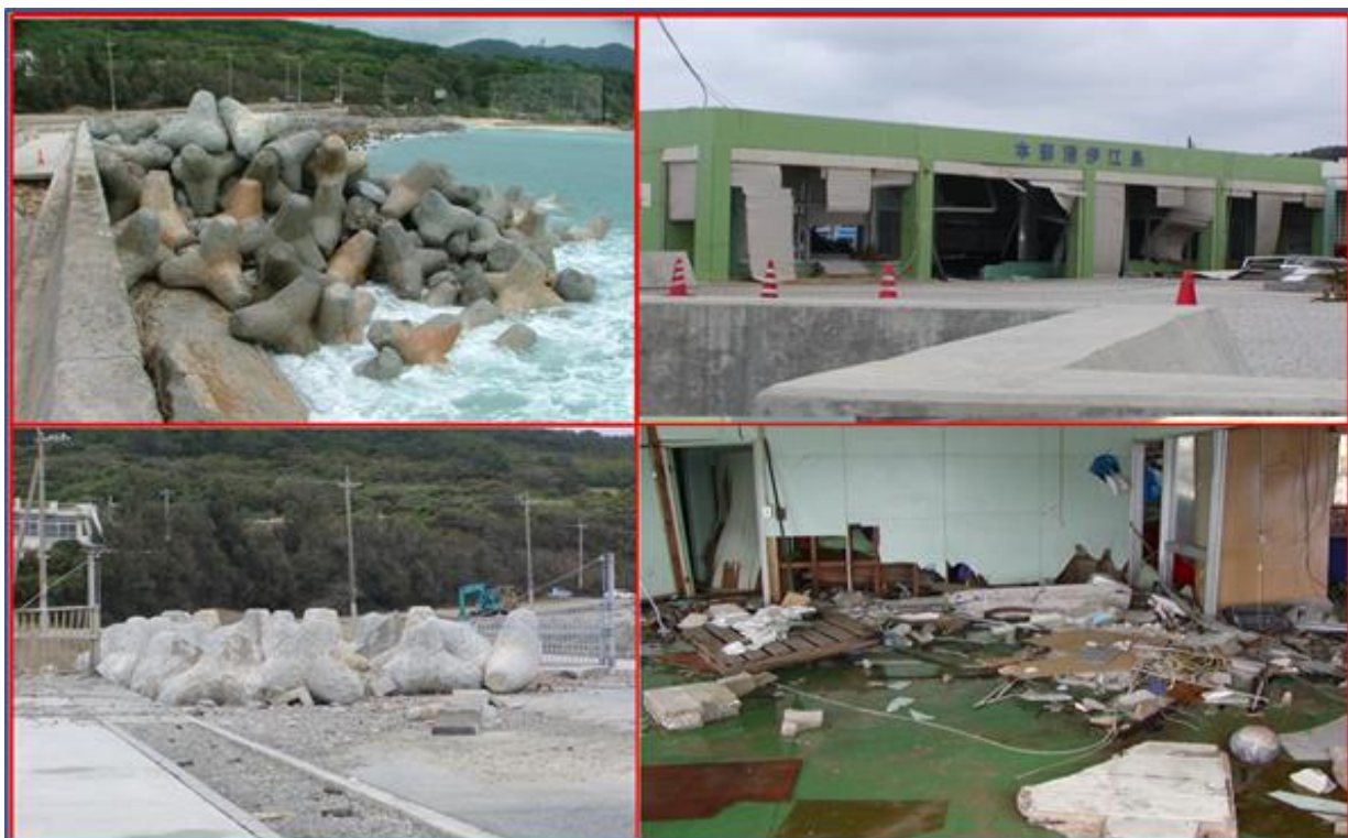
⑭ 2006. 9. 16-9. 17 本部港の被害写真（沖縄気象台提供）
