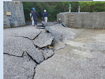
上原第二浄水場【被災状況】
