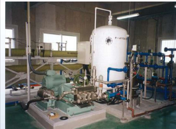
海水淡水化設備
