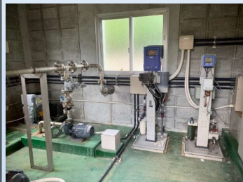
舟浮浄水場【水質監視装置】
