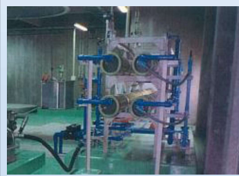
海水淡水化設備【膜ろ過】
