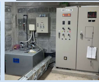
小浜配水池【計装設備】
