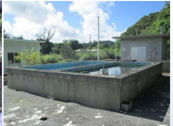
舟浮浄水場【ろ過池】
