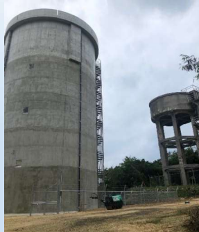
竹富配水池【新旧】
