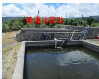
上原第一浄水場【普通沈澱池】
