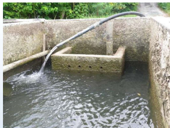
白浜浄水場【沈澱池】
