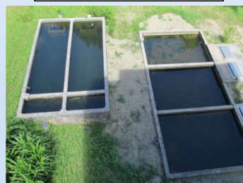
祖納浄水場【ろ過池】
